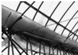
ワイヤーによる補強
