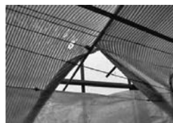
天井カーテンの隙間
