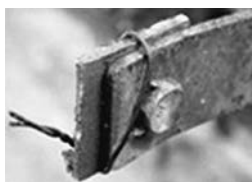
ブレース部の破断
